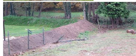
Verwallung / Mauern BCE, www.hochwassermanagement.rlp-umwelt.de
